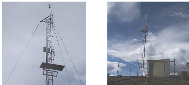
Figura 7.7: Torre y caseta de un repetidor.
