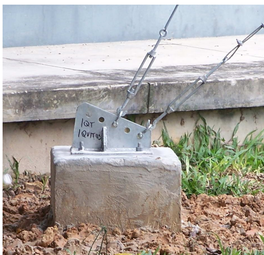
Figura 5.15: Ferretería de sujeción de vientos de torre.
