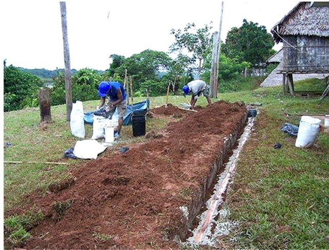
Figura 7.14: Pozo de Puesta a Tierra.
