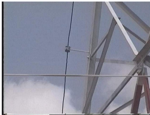
Figura 4.14: Vista del cable de bajada del pararrayos aislado de la estructura.
