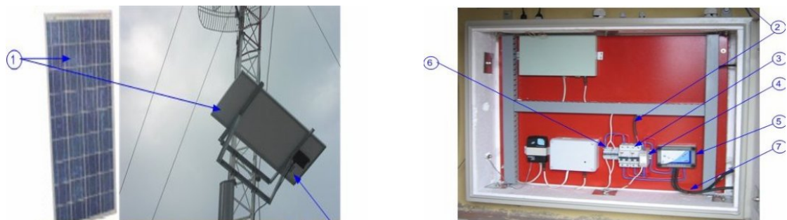
Figura 7.6: Partes de subsistema de energía en caja metálica.
