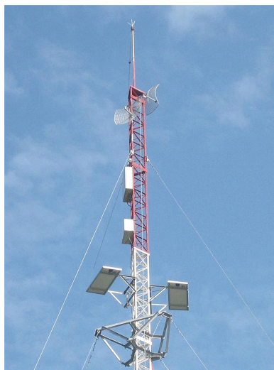
Figura 7.23: Torre ventada y antenas.
